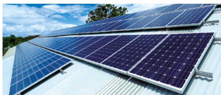
KS Solar Rooftop / หลังคาโซล่าเซลล์
